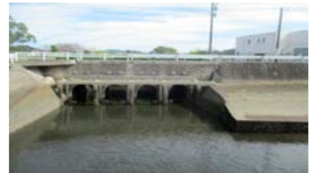
百間排水口・老朽化した樋門の扉は取り外し保管されている。
